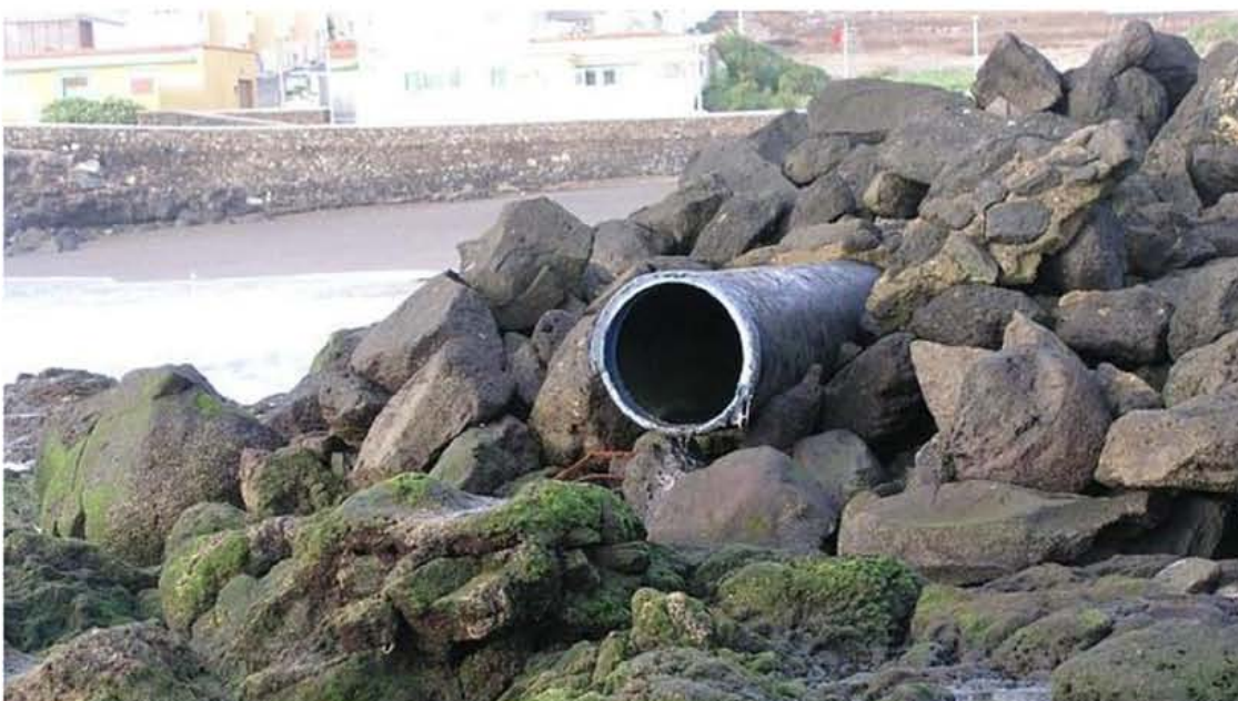
Imagen de archivo de un tubo para el vertido sin control al mar, en Canarias.
